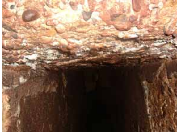
写真-1 流入水路の劣化状況(施工前)
