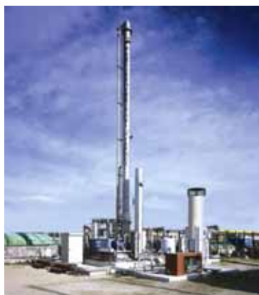
写真 1 実証設備全景
