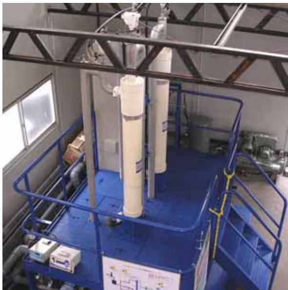
写真 1 1 段目膜ろ過装置外観
