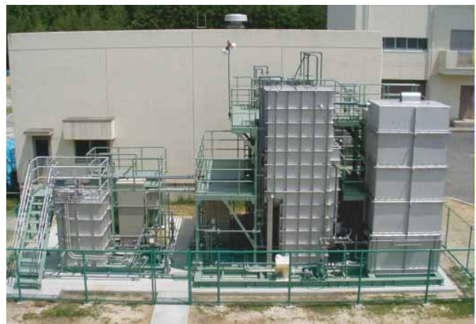
写真 1 UASB/DHS システムの全景
