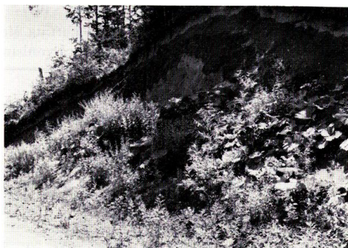
写真-12 崖錐部への侵入(木樋支線 林道 plot No. 7)
