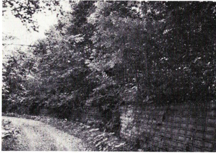
写真-7 切取法面（抑止工のみ）侵入植生（木本）による自然回復
