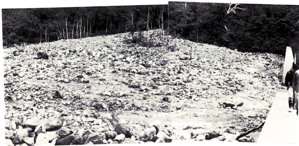
写真-5 砂防ダムの堆砂状況 (D-1, 施工後13年)
