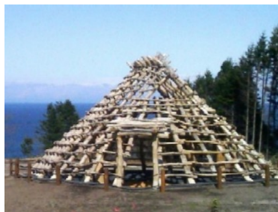
図 2-3 復元中の大船 C 遺跡の竪穴住居（北海道函館市南茅部地区）
