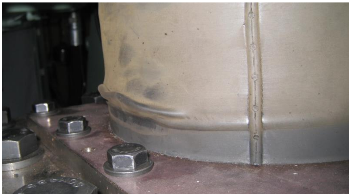
写真 4.3 座屈破壊による内部鋼板の圧壊
