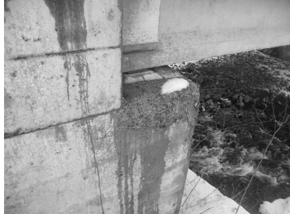
写真-1.2.10 橋台スケーリング2 (進展)
