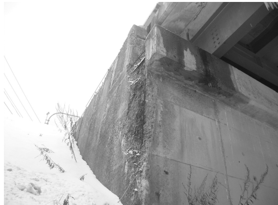
写真-1.2.11 橋台スケーリング3 (鋼材腐食)
