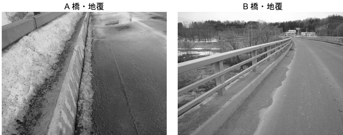
写真-6.4.3 冬期の地覆の状況 (塗布 5 年後の 3 月に撮影)
