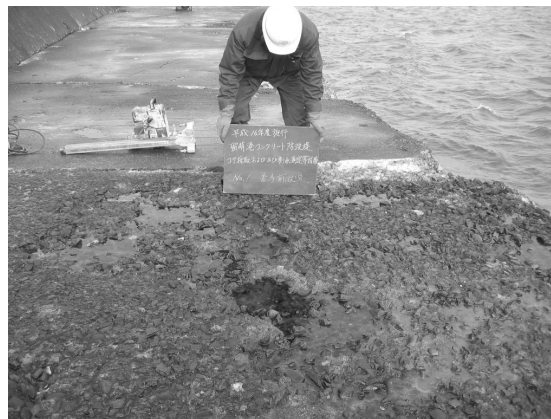
写真-3.2.1 スケーリングの一例（A港, a1, 剥離度31mm）
