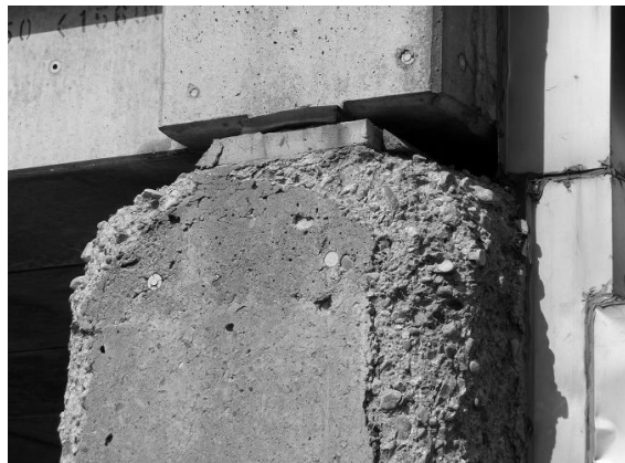
写真-1.1.2 スケーリング被害（橋脚）
