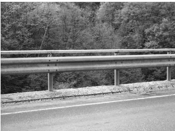
写真-1.2.8 地覆スケーリング3 (鋼材腐食)
