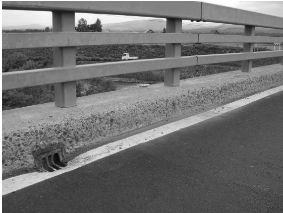
写真-1.2.6 地覆スケーリング1 (顕在化)
