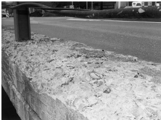
写真-1.2.7 地覆のスケーリング2 (進展)
