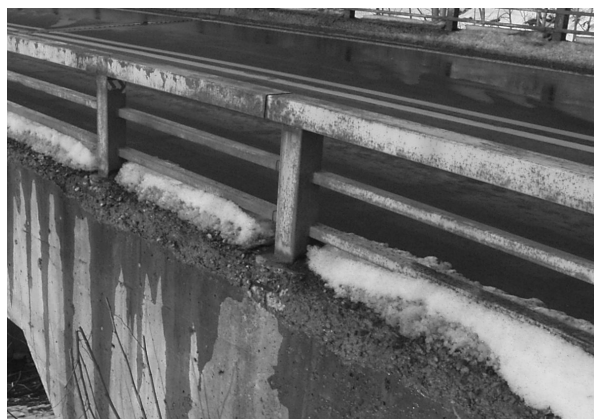
写真-1.1.1 スケーリング被害（地覆）
