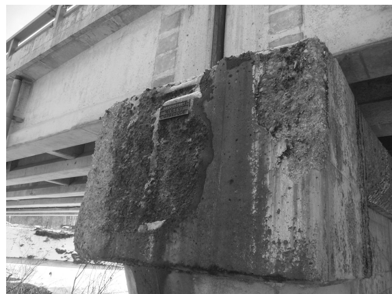
写真-1.2.4 スケーリング被害 (橋脚)
