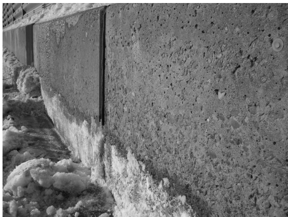
写真-1.2.3 スケーリング被害 (剛性防護柵)
