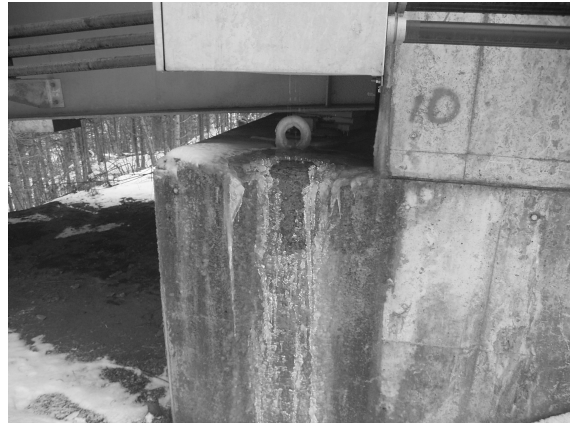
写真-1.2.9 橋台スケーリング1 (顕在化)
