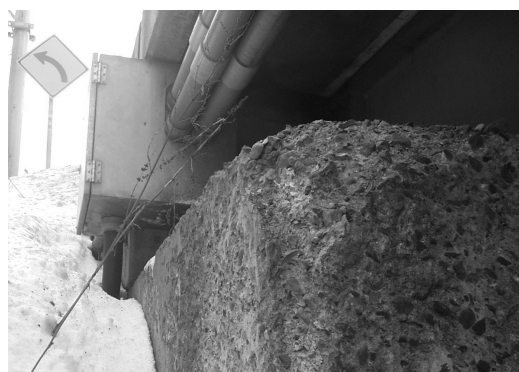
写真-1.2.5 スケーリング被害 (橋台)
