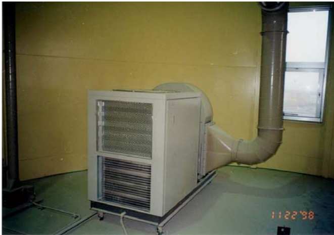
写真2 サイロ内空間自動換気装置
