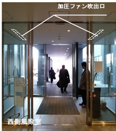
図 5.29 風除室吹出口
