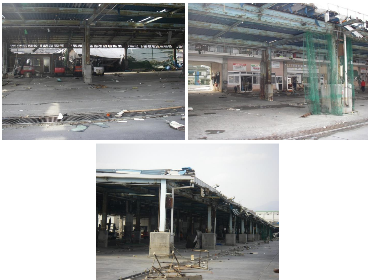
図 4-5 東日本大震災による大船渡魚市場（永沢地区）の被災状況
