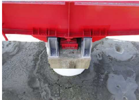
b) 橋脚周りの噴砂状況
