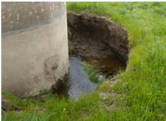
a) 確認された橋脚の移動の痕跡
