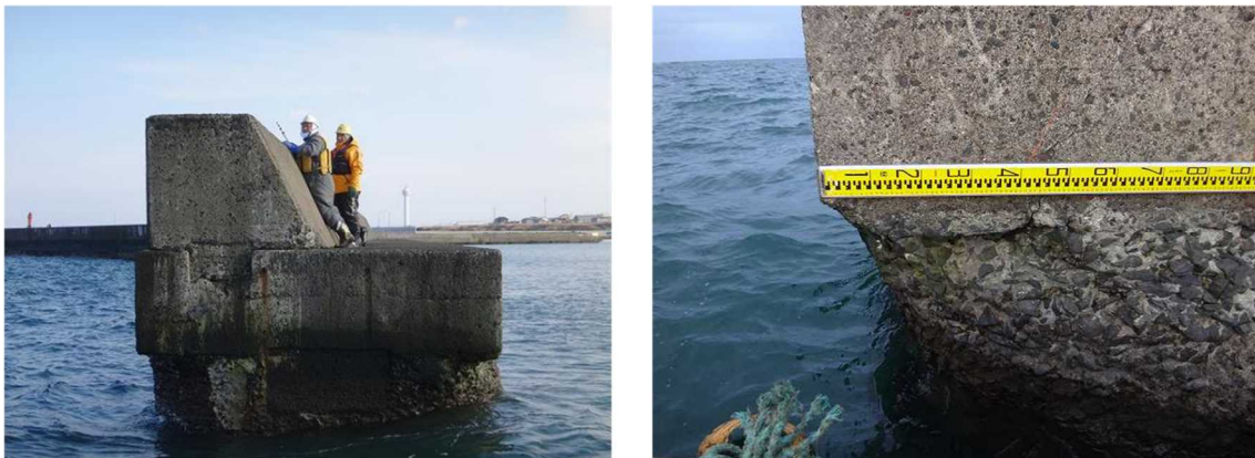
写真-4-3-1 防波堤干満帯のコンクリート劣化事例
