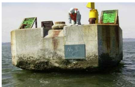
写真-5-2-1 氷海域にあるコンクリート構造物の劣化状況
