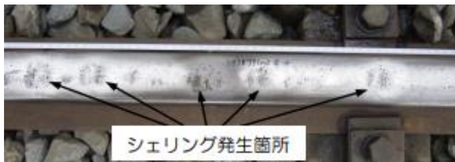
図 4-1 頭部横裂の発生が疑われる箇所のレール頭頂面凹凸
