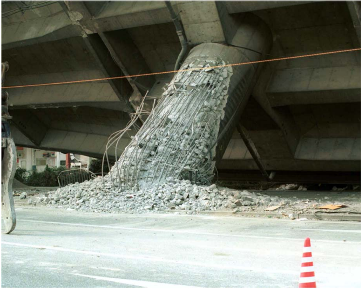
図一1 コンクリート製橋脚の地震による詳細な破壊性状（首都大学東京 吉嶺先生提供）
