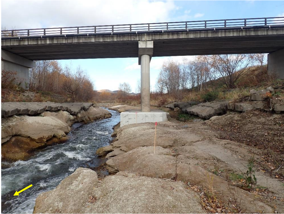
図 1-3 フーチングの露出が見られる無加川朝日橋
