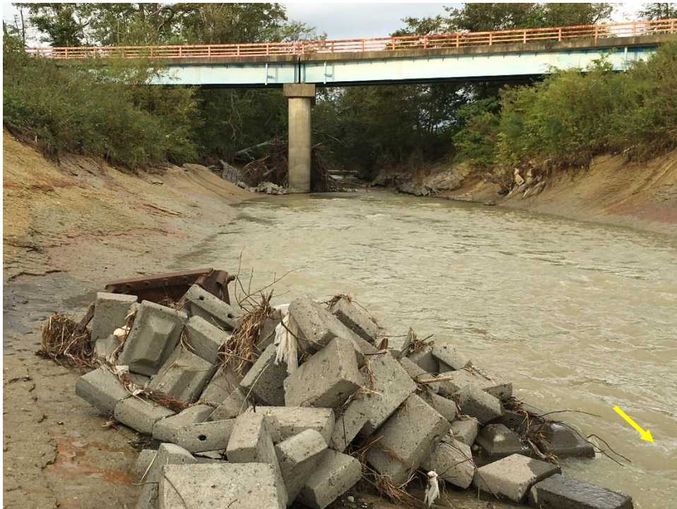
図 1-2 平成 28 年台風 10 号によって被災した上士幌川
