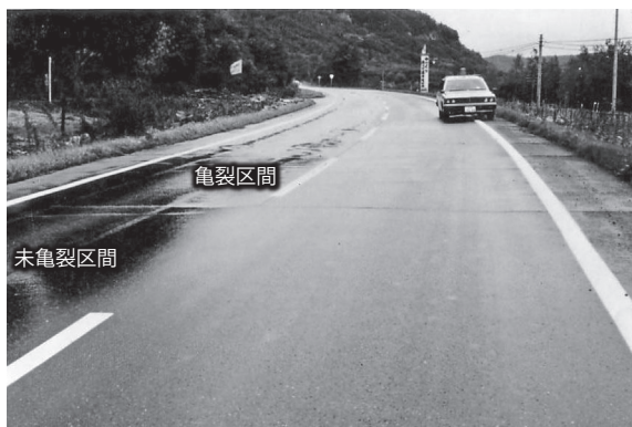
図3 アスファルト舗装の横断亀裂が発生した箇所(向こう側)と手前の発生していない箇所(陸別)
