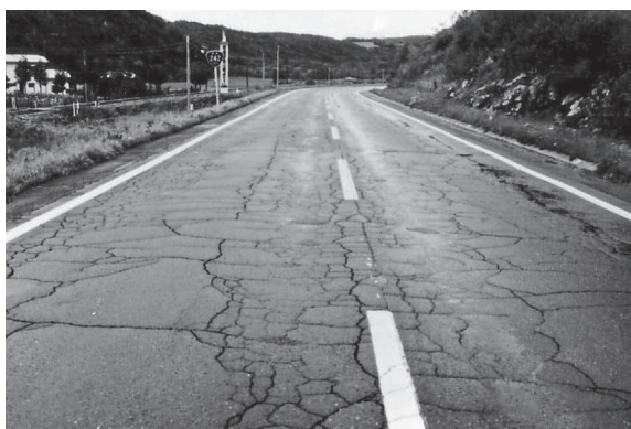
図4 図3と同じ舗装箇所の5年後のオーバーレイ後の舗装表面の亀裂(写真の向きは図3と反対)(陸別)
