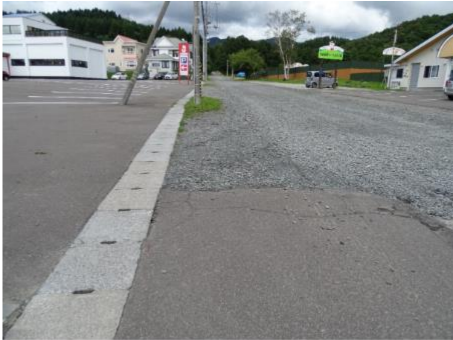
図 6. 陣川町に残る未舗装の道路
