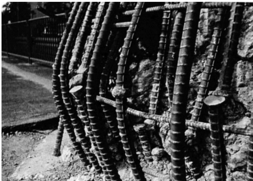
写真1 阪神高速3号神戸線 圧接部の破断
