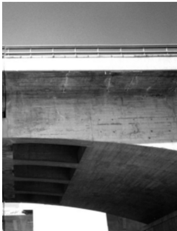
図2 旧十勝大橋のコンクリートの床版 (画像提供：北海道開発局)
