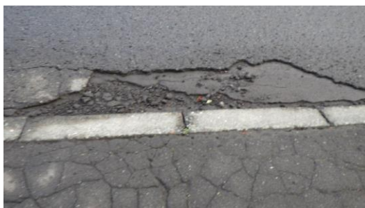
(f) 表層剥離[12]
