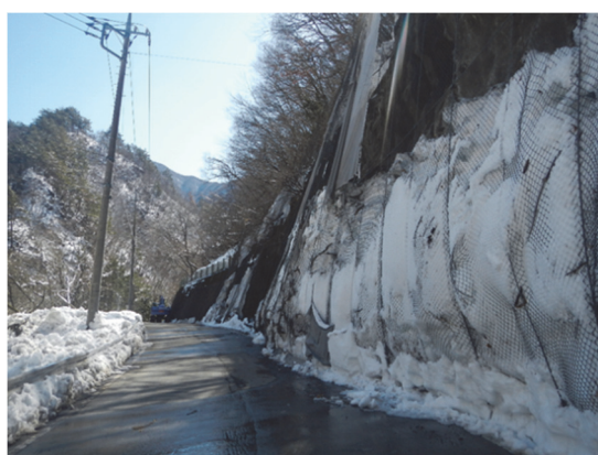
図 3-12 内側にデブリが入り込んでいる落石防護網（中村ら，2014）
