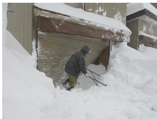
図 3-16 表層雪崩により被害を受けた福島県檜枝岐村上ノ原地区の国道 352 号沿いの家屋（中村・上石，2019）
