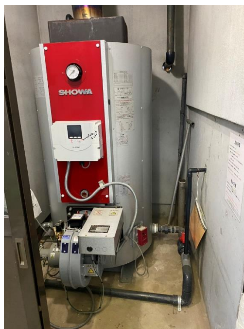
写真3：ボイラー室（2023年11月7日筆者撮影）
