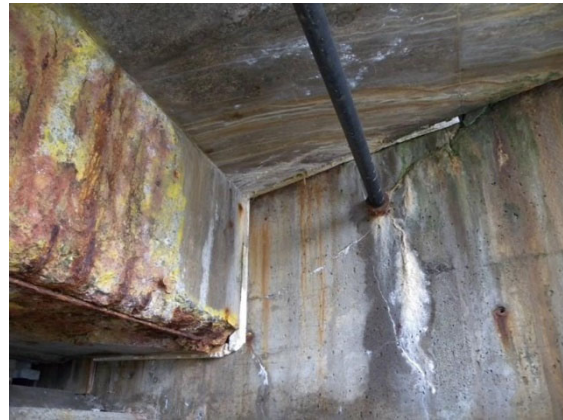
(d) 桁端からの漏水が桁側面に波及
