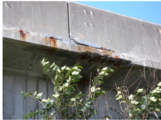
(b) 壁高欄の隙間
