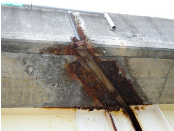
(c) 掛け違い部の壁高欄の隙間
