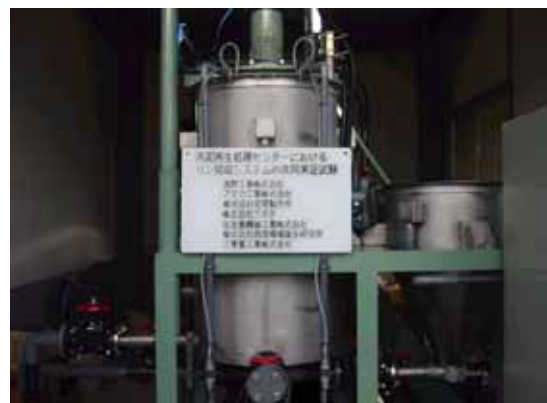
図 2 実証試験設備
