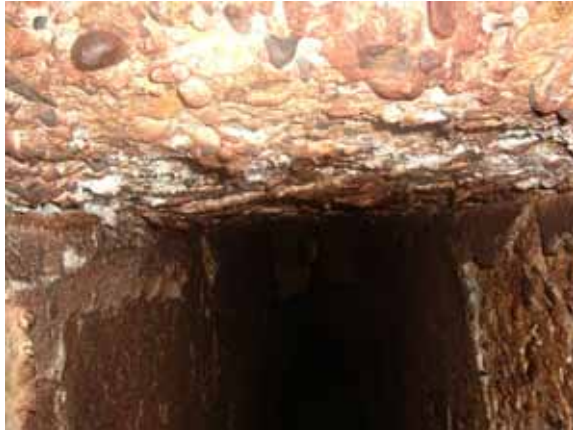
写真-1 流入水路の劣化状況(施工前)
