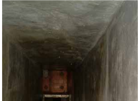
写真-2 耐硫酸モルタル施工後の流入水路 (写真-1と同じ場所)
