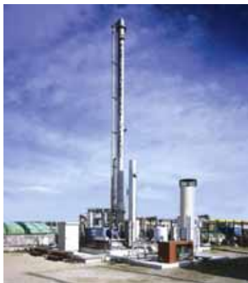
写真 1 実証設備全景
