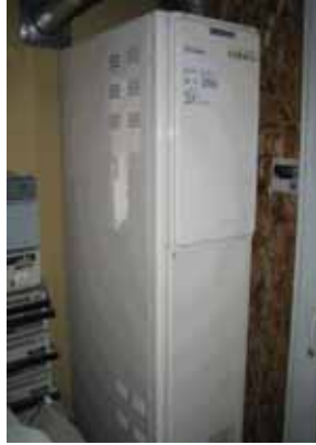
排熱利用給湯暖房ユニット
