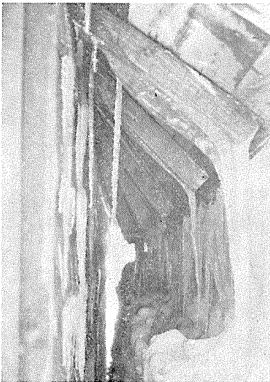
積雪の沈降荷重による軒先の破壊
