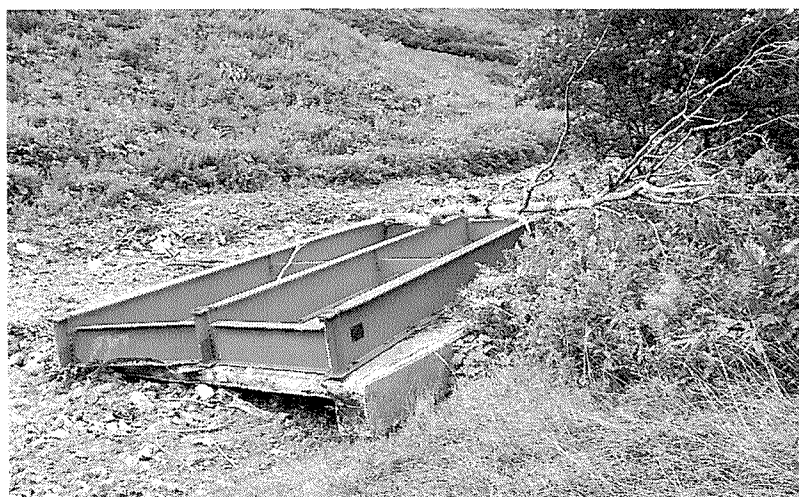
第4図 80m流された橋脚 橋は上下反転しその上に折れ木があるが土砂の堆積はない
