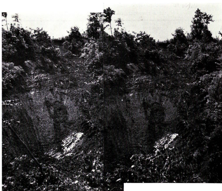
写真 5 1964年6月3, 4日の降雨 (135 mm) で発生した崩壊地 (平取・二風谷)
