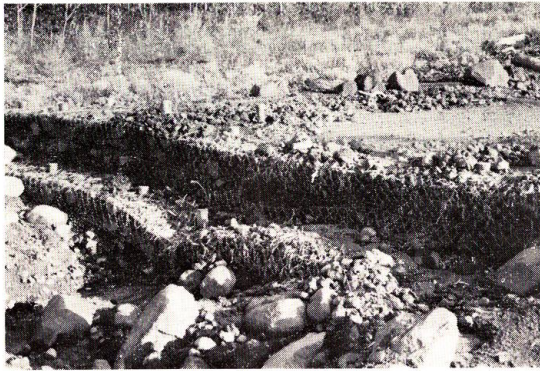
図-46. フトン籠による床固工は, 洗掘に応じて変形し, 天端をレベルに維持することができない
