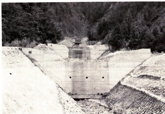
図-43. 扇状地に設けられた砂防ダムの洗掘状況
