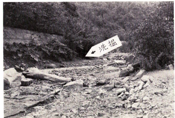
図-35. 上流部からの土砂流送が抑制されたために、下流部では洗掘がいちじるしくなり、旧護岸工の根が不安定になった
