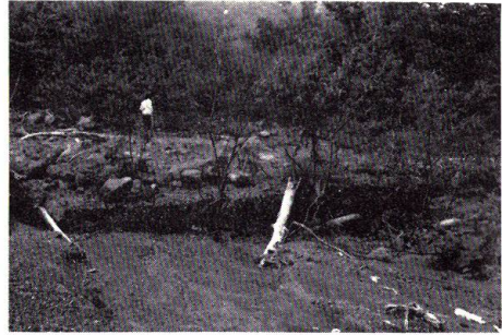
写真一4 土石流によって変形しているフトン籠土留工 (滝の沢)
