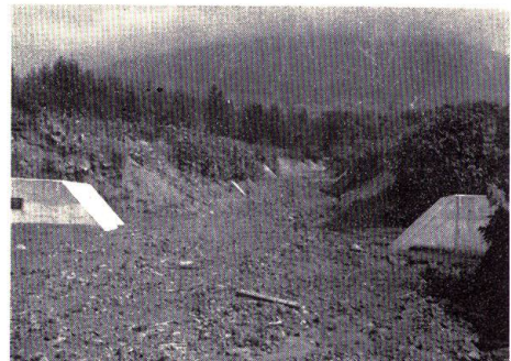
写真一6 扇状地末端の流路工と流末水を誘導したあとの状態 (雪崩の沢)
