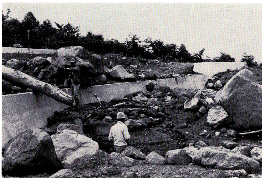
写真—6 床固工群により堆積土石の中央部に流路が形成される (青木の沢扇状地, 1975, A 堆積地) Photo 6. New Channel Course formed the center of Dispersed Deposits (Aokinosawa Fan, 1975, A-deposit).
