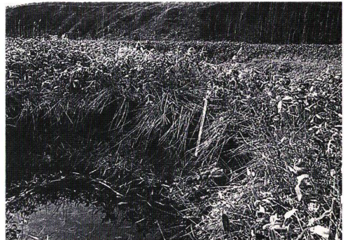
写真-4 sp 6680 m 地点の侵食地形 半球状にえぐられ、そこには常時水が溜まっている。
