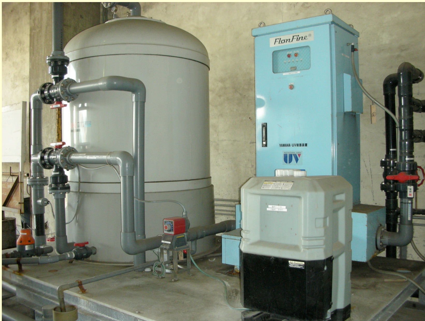
UV treatment Unit : 釧路港の紫外線殺菌装置
