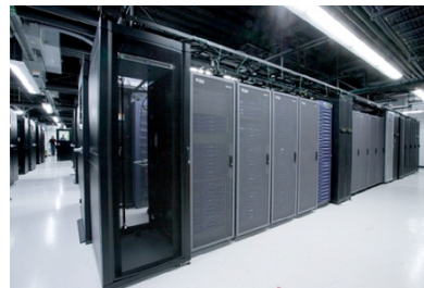
データセンター
