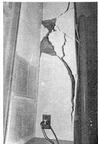
写真-6 市立根室病院外来棟柱の剪断亀裂
