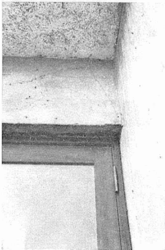
写真-17 北斗小学校体育館 梁端亀裂
