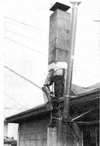
写真-3 桂木団地煙突の損傷
