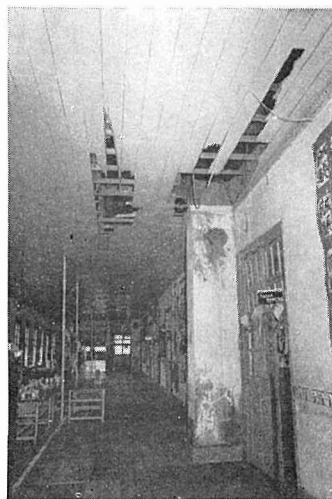
写真-19 花咲港小学校煙突の崩落
