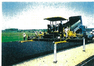
写真-6 写真-5撮影時のフィニッシャーおよび混合物運搬用トラックの施工状況
