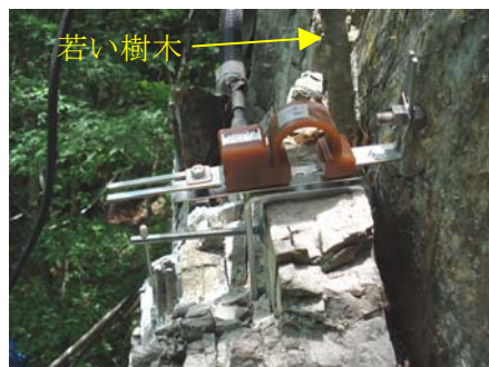
図2 樹木進入部に設置した亀裂変位計 No.4
