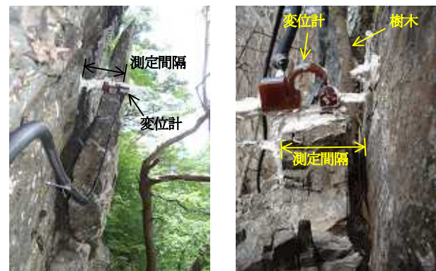
写真-1 表面亀裂変位計の設置状況（測定間隔はともに 20 cm 程度）
