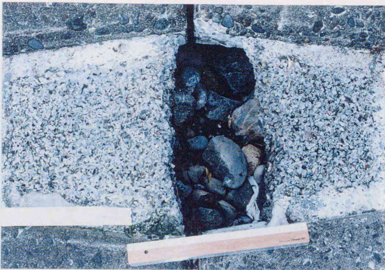
Photo 5.5 劣化形態(透水係数=0.1cm/s) 3シーズン経過後 (その1)
