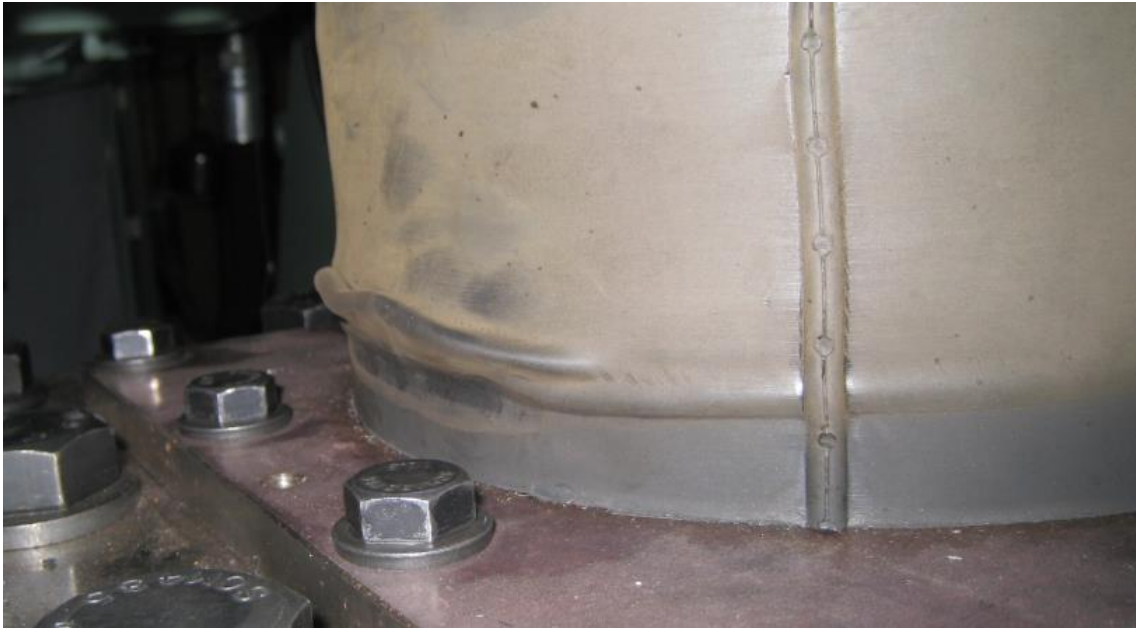
写真 4.3 座屈破壊による内部鋼板の圧壊
