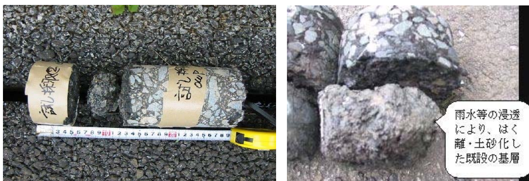
写真 4-5 基層混合物の剥離状況
