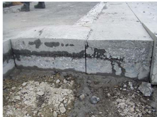
写真 4-19 外側線のひび割れからの浸透水
