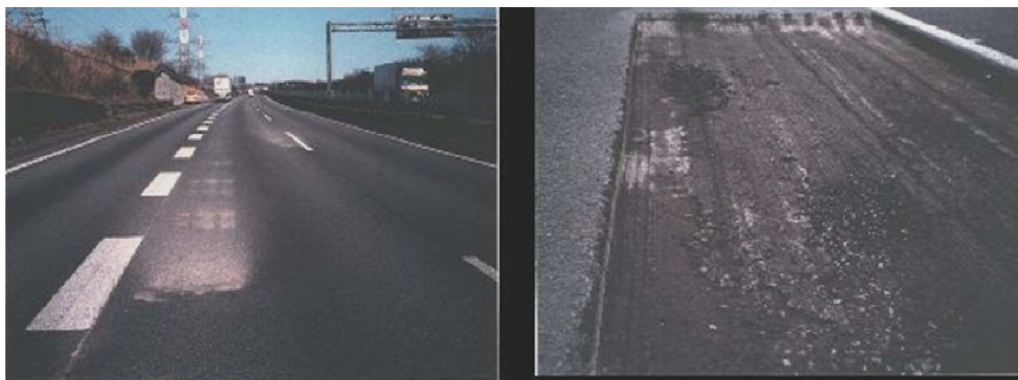
写真 4-6 高機能舗装のポンピングの例
