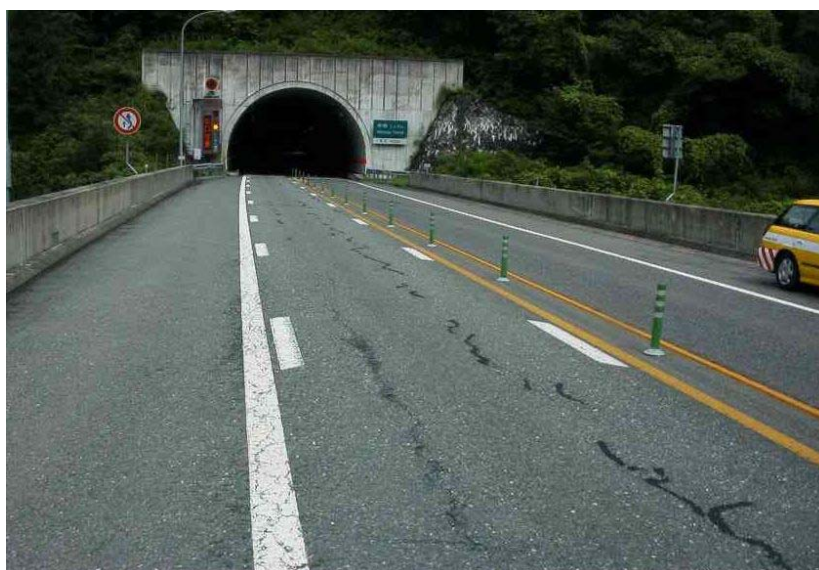
写真5-1 高速道路におけるひび割れ発生例
