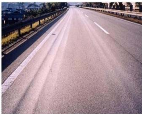
写真 2-1 Wわだち掘れの発生例
