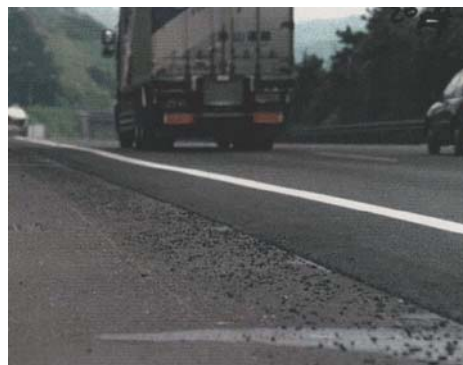
写真 4-1 高機能舗装のラベリング
