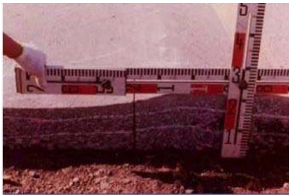
写真 2-2 流動わだち部の開削断面の例
