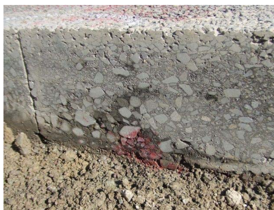
写真 4-16 ポンピング直下のアスベースの緩み
