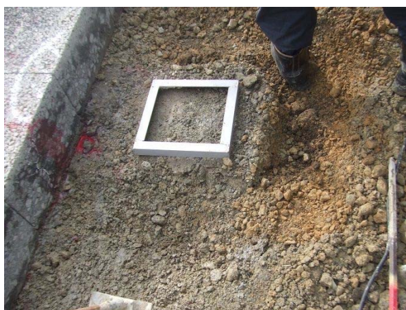
写真 4-13 ポンピング発生箇所の路盤滞水 （左）A工区 （右）B工区
