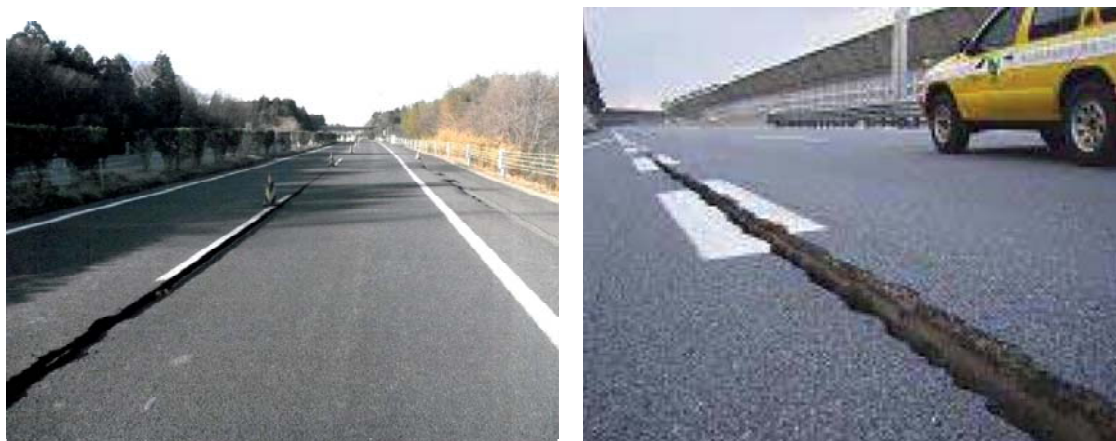
写真 5-6 施工目地部に発生した縦断亀裂（東日本大震災）
