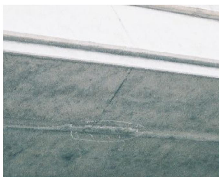
PC 桁の遊離石灰 (d、B) 写真 3-31 2001 年の損傷状況
