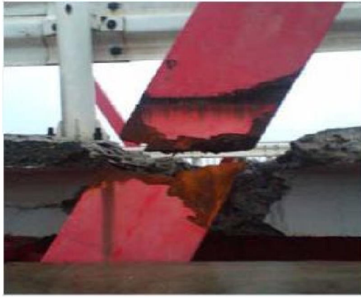
写真 4-5 トラス橋の斜材の破断
