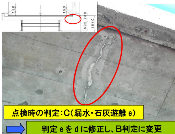
損傷度区分判定を見直した事例
