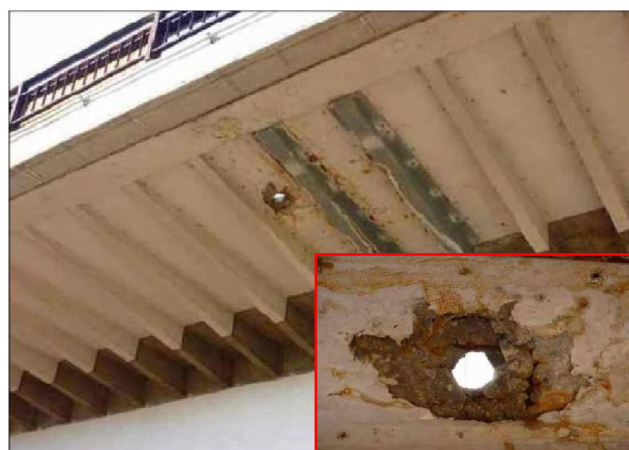
写真 3-9 土砂化により貫通した床版
