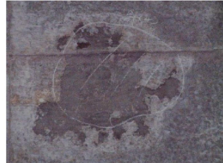
写真 3-36 左写真の 2008 年の損傷状況
