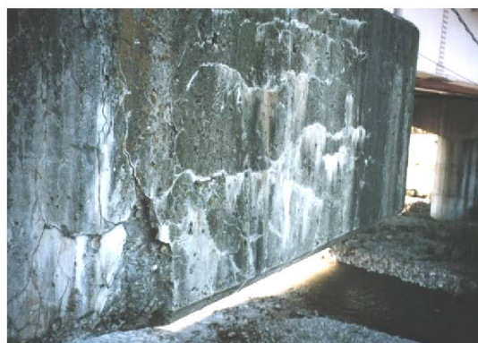
写真 4-3 橋脚梁部の亀甲状のひび割れ
