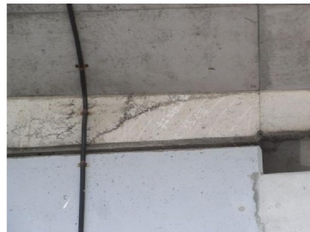
写真 3-40 左写真の 2008 年の損傷状況
