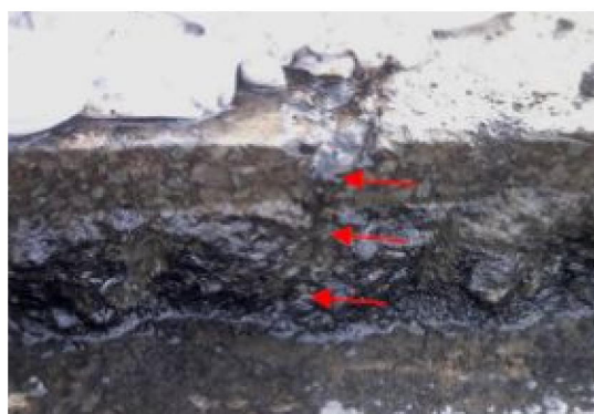
写真 5-11 舗装の貫通ひび割れ
