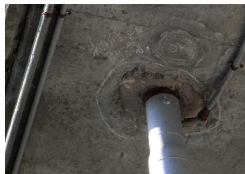
写真 3-48 左写真の 2008 年の損傷状況
