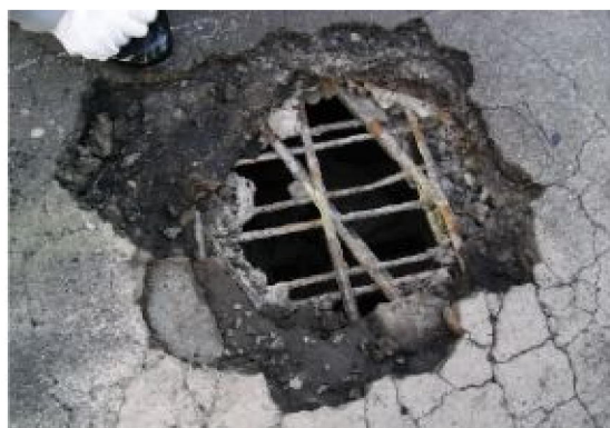
写真 5-1 床版の抜落ちの事例 (資料提供；(独) 寒地土木研究所)
