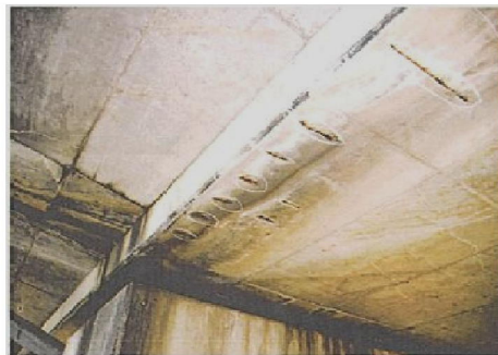
RC桁の剥離・鉄筋露出（d、C） 写真 3-41 2001 年の損傷状況
