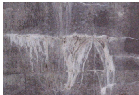
写真 3-38 左写真の 2008 年の損傷状況
