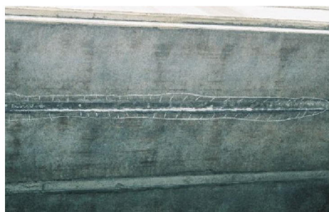
PC 桁の遊離石灰 (d、B) 写真 3-29 2001 年の損傷状況
