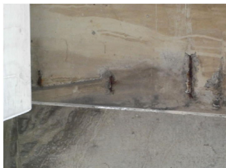
写真 3-46 左写真の 2008 年の損傷状況
