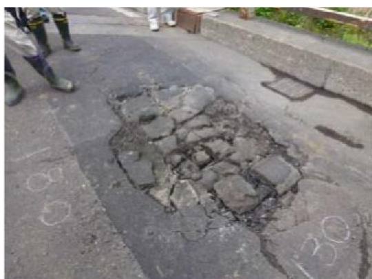
写真 5-2 抜落ち箇所の舗装の状況 (資料提供；(独) 寒地土木研究所)
