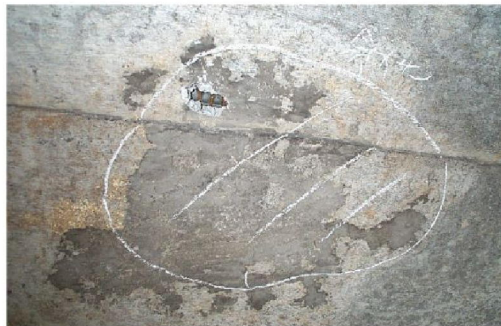
PC桁の剥離・鉄筋露出（e、C） 写真 3-35 2001 年の損傷状況
