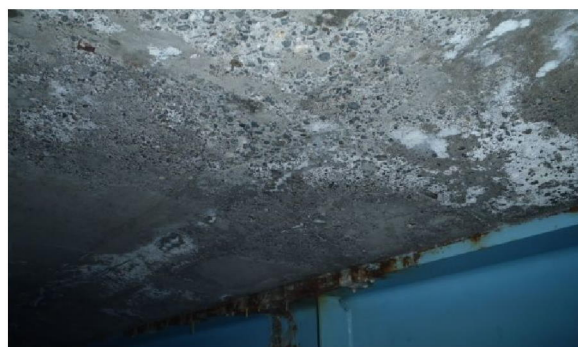
写真 5-16 下面劣化の様子（その2）
