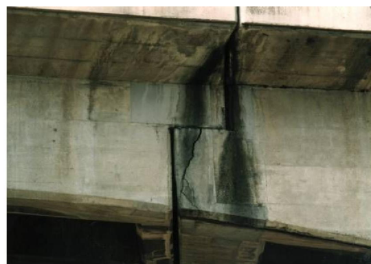
写真 4-2 ゲルバーヒンジ部の斜めひび割れ
