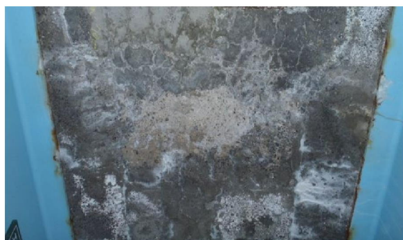
写真 5-15 下面劣化の様子（その1）
