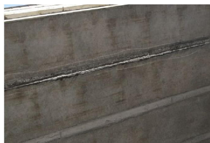
写真 3-30 左写真の 2008 年の損傷状況
