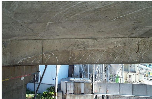
PC桁のうき（e、C） 写真 3-33 2001 年の損傷状況
