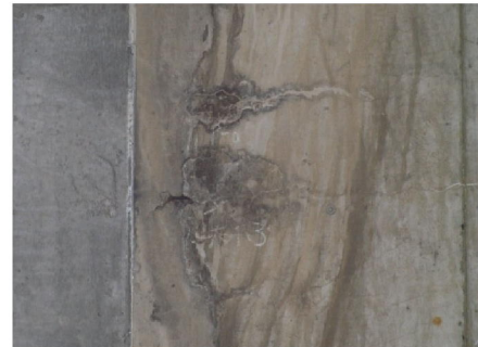
写真 3-44 左写真の 2008 年の損傷状況
