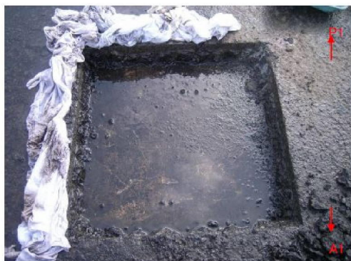
写真 5-10 鋼床版上面の滞水
