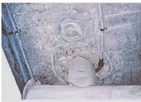
R C桁の剥離・鉄筋露出（d、C） 写真 3-47 2001 年の損傷状況
