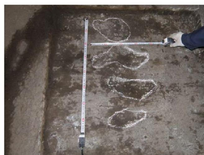
写真 5-6 床版上面砂利化
