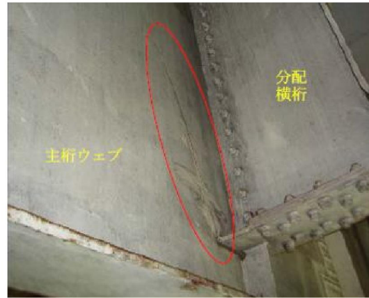
写真 4-5 鋼鈑桁の主桁ウェブの亀裂 (以上の写真の出典；国土交通省記者発表資料)
