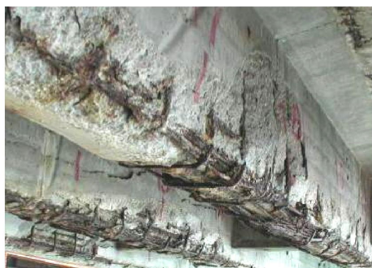
写真 4-1 塩害による鉄筋露出
