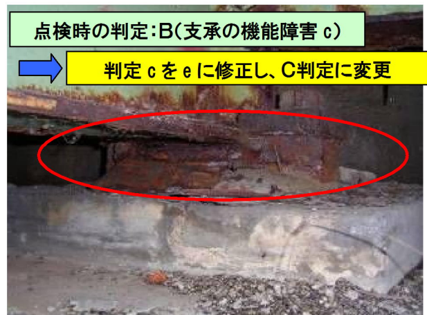
損傷度区分判定を見直した事例
