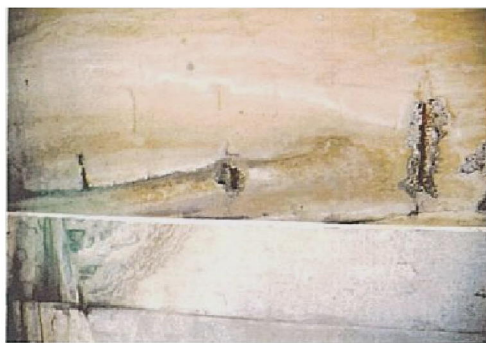
R C桁の剥離・鉄筋露出（d、C） 写真 3-45 2001 年の損傷状況
