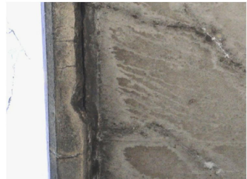
写真 3-50 左写真の 2008 年の損傷状況
