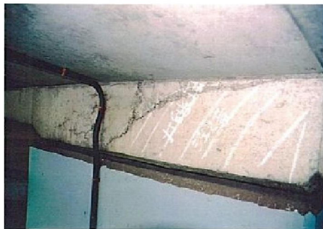
RC桁のひびわれ、うき（e、C） 写真 3-39 2001 年の損傷状況
