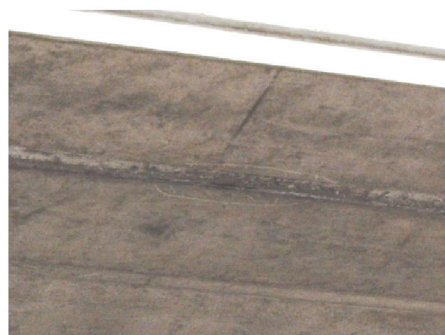
写真 3-32 左写真の 2008 年の損傷状況
