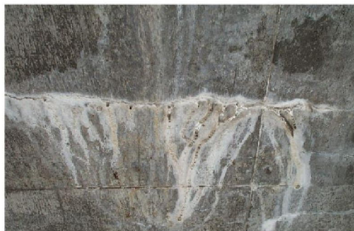
PC桁の漏水・遊離石灰（e、C） 写真 3-37 2001 年の損傷状況
