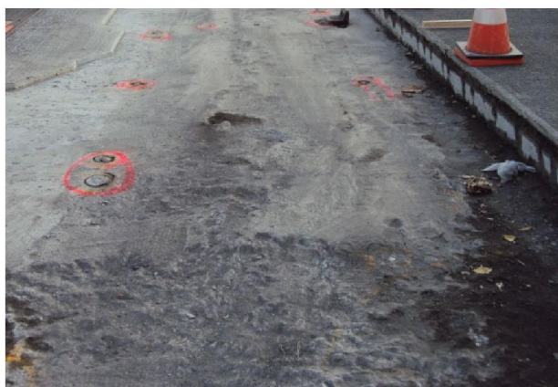
写真 3-4 既設床版の脆弱部
