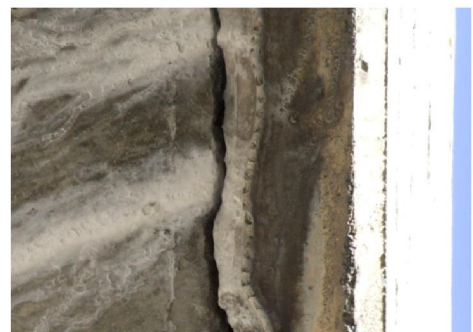
写真 3-52 左写真の 2008 年の損傷状況
