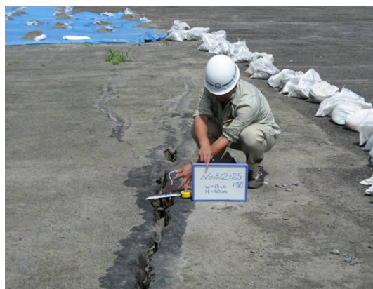
(a) 路床面の亀裂発生状況
