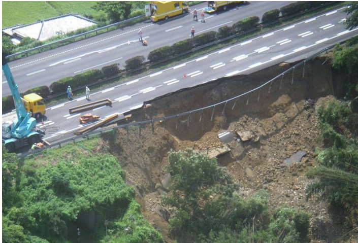
(a) 東名牧之原の盛土被災全景
