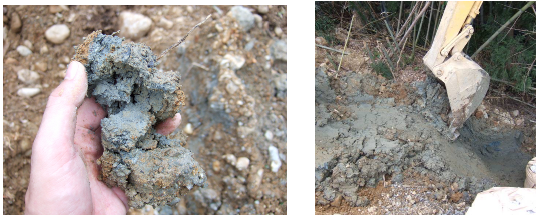
図-3.2.3 粘土化した泥岩盛土材の崩積土
