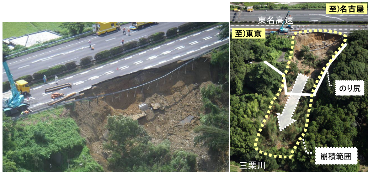
図-3.2.1 盛土の崩壊状況
