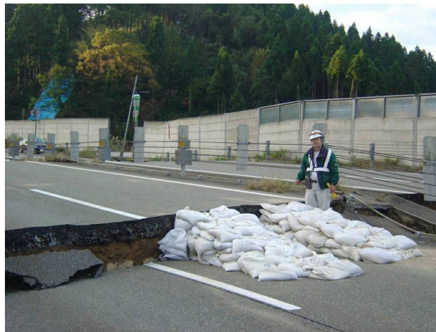
(b) 被災度中：走行支障を生じる構造物と土工部との段差
