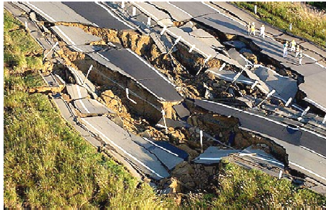
(a) 被災度大：走行車線まで及ぶ盛土崩壊
