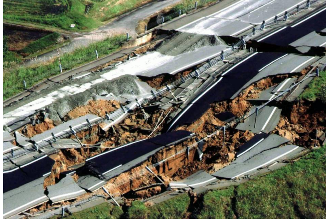
図-1.1.4 中越地震における高速道路の盛土被災
