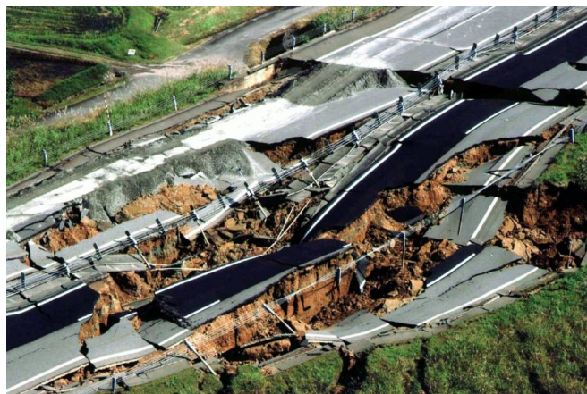
図-4.1.1 中越地震における高速道路の盛土被災
