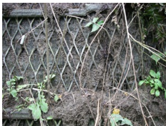
(c) 壁面材からの細粒分流出状況
