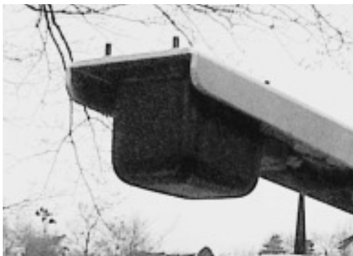
図2.5 供試GDSの外観
