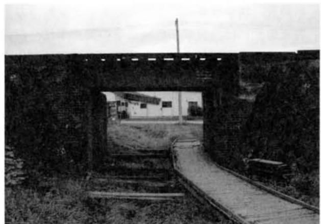
図14 帯広駅西側に存在した日ノ下川鉄橋。イギリス積みみの煉瓦橋台で、両側に続く築堤は谷積みみの石垣、桁橋はデッキガーダーだった。恐らく1907（明治40）年頃の築造と思われるが、詳細は不明。 1992年9月7日 遠藤忠氏撮影（帯広百年記念館所蔵）
