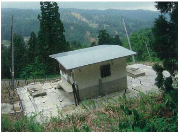
写真-1.1 RC池状構造物の傾斜（池谷・大久保配水池） 5)
