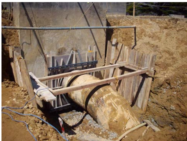
写真-1.3 急速混和池流出管の漏水（堀口浄水場） 11)
