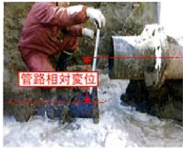
写真-1.4 洗浄タンク流入管の脱管（鰯川浄水場） 12)
