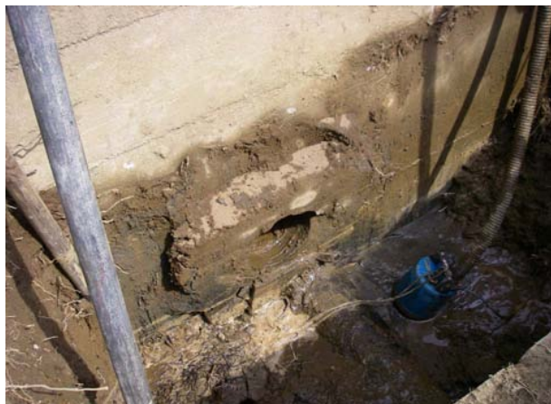
写真-1.2 浄水池越流管の管体損傷（虻田浄水場） 11)
